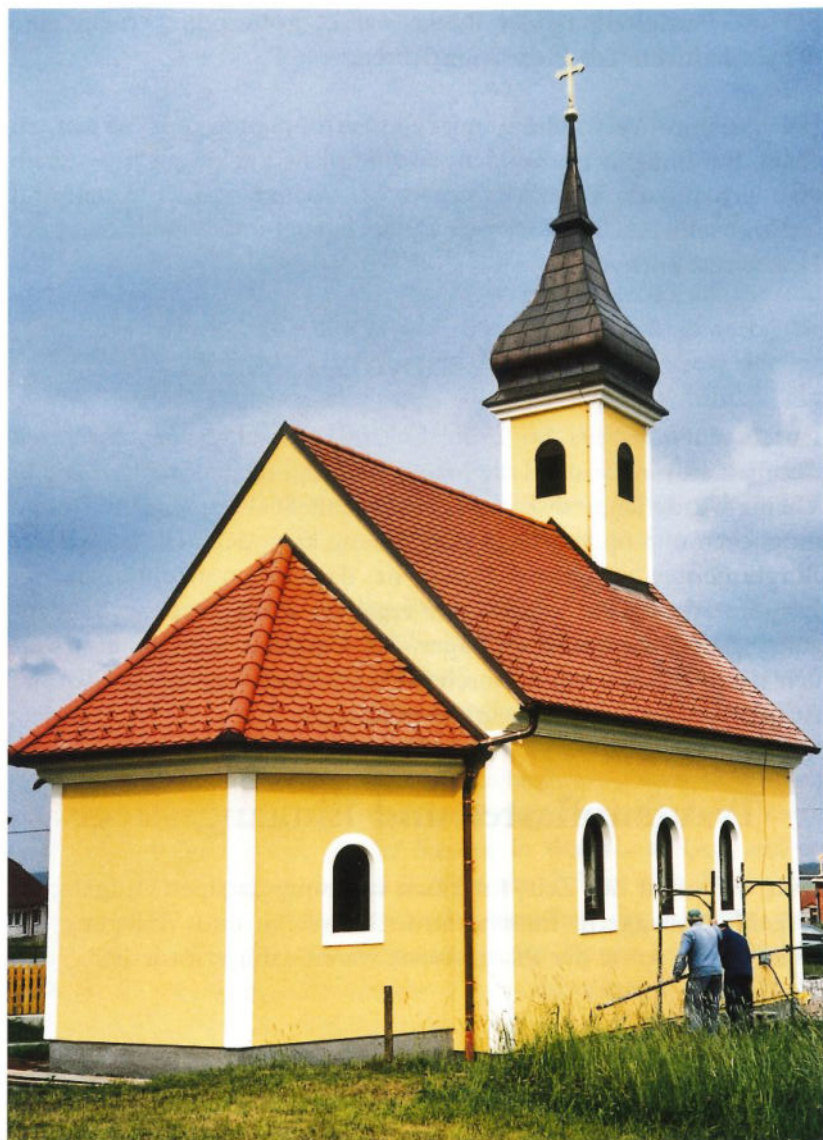
Nach dem Verputzen wurden innerhalb von nur 3 Tagen sämtliche Malarbeiten erledigt und anschließend am 2. Juni 2001 das Baugerüst entfernt.
